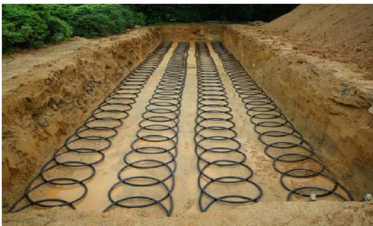
環境省 H22・23 年度地球温暖化対策技術開発事業で設置した水平型地中熱交換器
