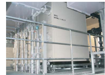
ヒートポンプ
