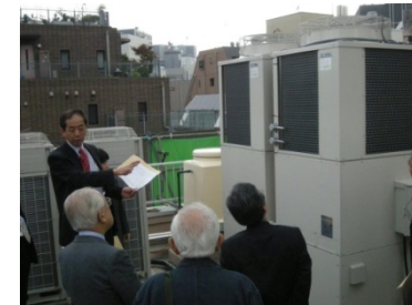
屋上に設置した 空水冷ヒートポンプ
