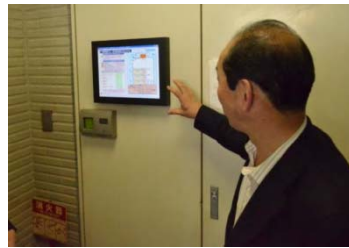
1階エントランスホールのモニター
