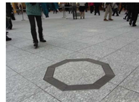
地中熱利用冷暖房の吹き出し口
