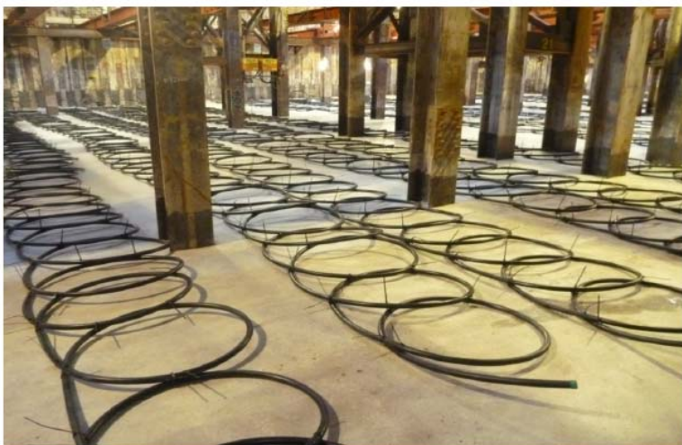
小田急電鉄(株)東北沢新駅のトンネル本体の下に設置した水平型地中熱交換器 (地表下約15m)
